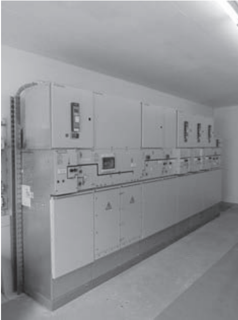
Schwaderloch, TS Hauptsstrasse mit Messstation: Kompaktschaltanlage gasiloliert
