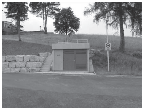
Neue Trafostation an der Schulstrasse
