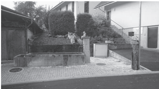
Neue Stromverteiler beim Schlössli-Brunnen
