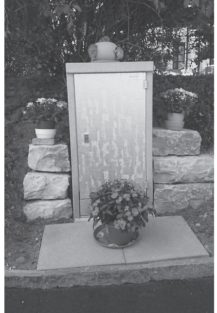
Bild: Neuer Stromverteiler, schön dekoriert vom Landeigentümer
