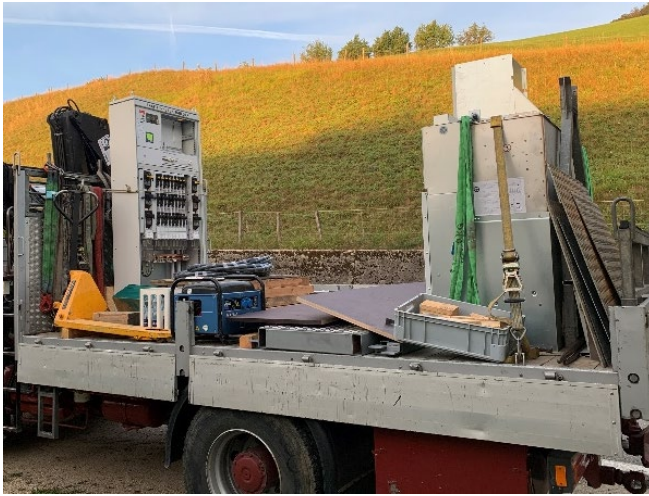
Anlieferung der neuen MS-Anlage inkl. Niederspannungsverteilung für die Trafostation Aeschboden in Oberhofen.
